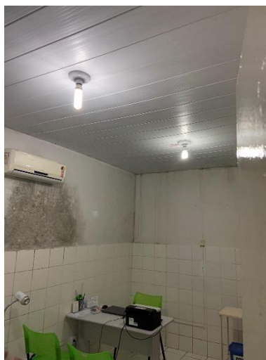
Figura 4: Remover infiltração e trocar luminárias.
