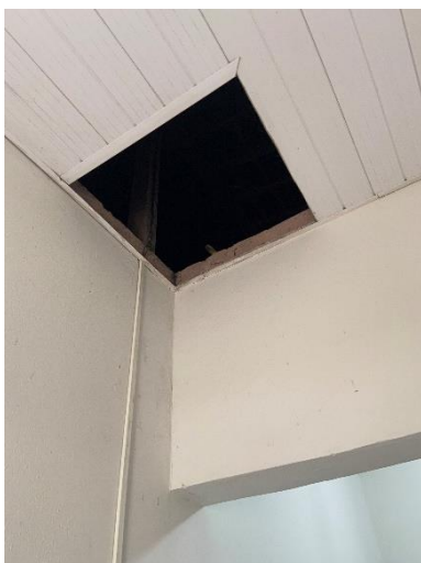
Figura 15: Revisão de forro pvc.
