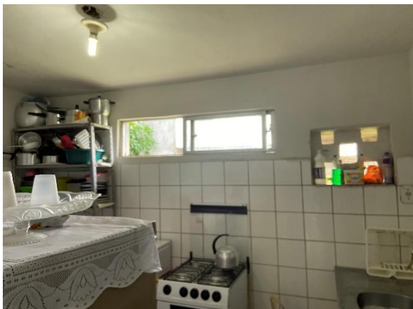
Figura 7: Substituir revestimento e aplicação de pintura.
